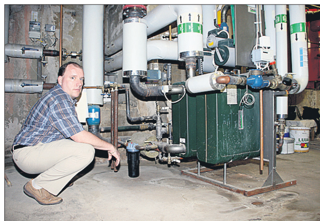
Rauhankadun lämmönjakokeskus on näyttävä systeemi. Vedenkäsittelylaite on lämmönjakokeskuksen putkiston osana. Laitteistoa esittelemässä isännöitsijä Juha Ranta.
